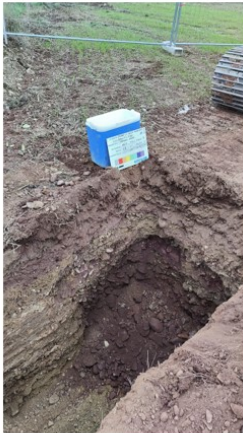
Foto 8. Evidenze organolettiche "canale Oleum" in corrispondenza della trincea AEs_TR1
